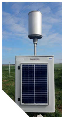
Capteur pluvio + panneau solaire
