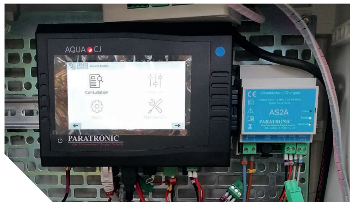
Installation d'un coffret AQUA-CJ à Chazey
