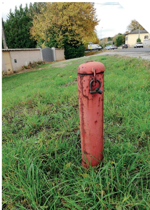
Tête de puits de forage
