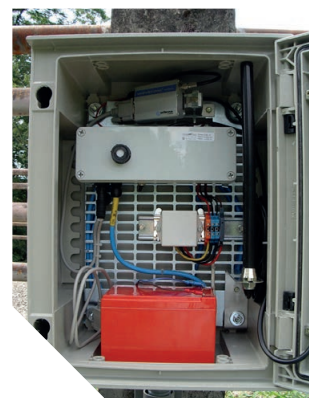
MAC dans coffret pour un étage CNR
